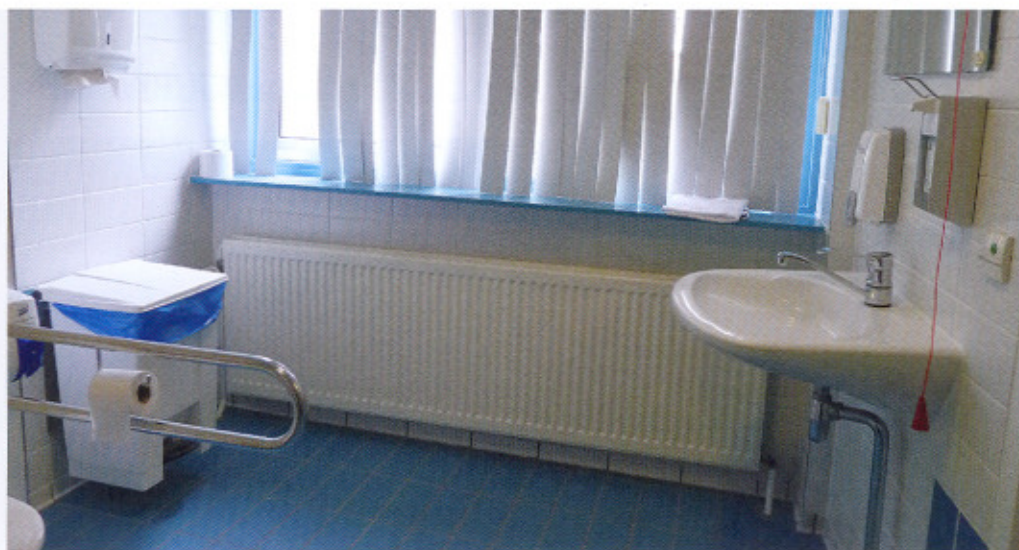
ZORGINSTELLING MET EEN WASTAFELSECTIE IN EEN KLEEDKAMER, WAAR DE ROLSTOELER NA HET HANDEN WASSEN DE ROLSTOEL (MET DE NATTE HANDEN AAN DE WIELEN) OM MOET DRAAIEN EN VERVOLGENS EEN HANDDOEK MOET ZIEN TE PAKKEN UIT EEN TE HOOG HANGENDE DISPENSER BOVEN EEN AFVALBAK (ECHT NOOIT TE BEREIKEN VANUIT EEN ROLSTOEL). EEN VOORBEELD VAN ONDESKUNDIGHEID BIJ ONTWERPER EN INSTALLATEUR.
